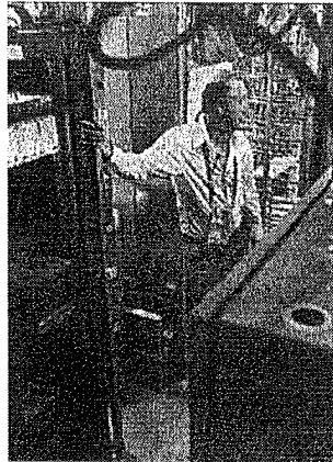
Le central, installé au stade. D. C.
